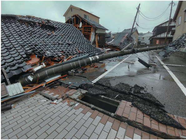
輪島市中心部の倒壊した家屋
