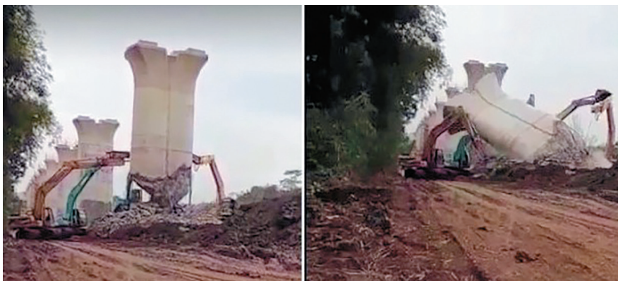
中国主導で進む高架鉄道敷設中、支柱が崩落し、クレーン車数台を破壊(2021年12月、インドネシア・カラワン地区にて)
