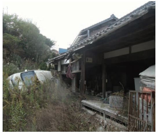
廃屋となった駅前の民家裏庭
